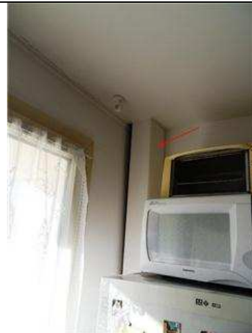
028 - Appartements - Cuisine LOT 0201 PH13 : amiante ciment
